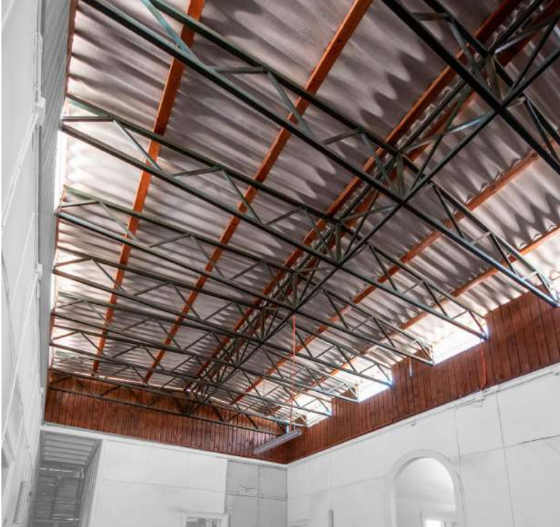
Img. n°78 Cubierta de espacio central de estructura metálica evidenciando añadidos contemporáneos sin relación a la edificación histórica. © Corsa Arquitectos.
