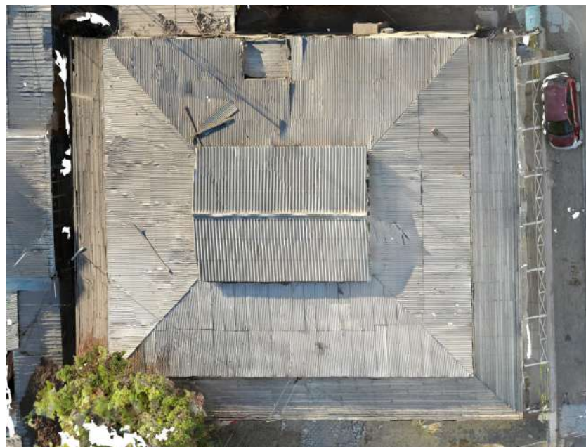
Img. n° 44 Ortofoto (octubre de 2024) que evidencia el estado de las cubiertas y sus modificaciones, destacando la incorporación de zincalum no original. © Corsa Arquitectos.
