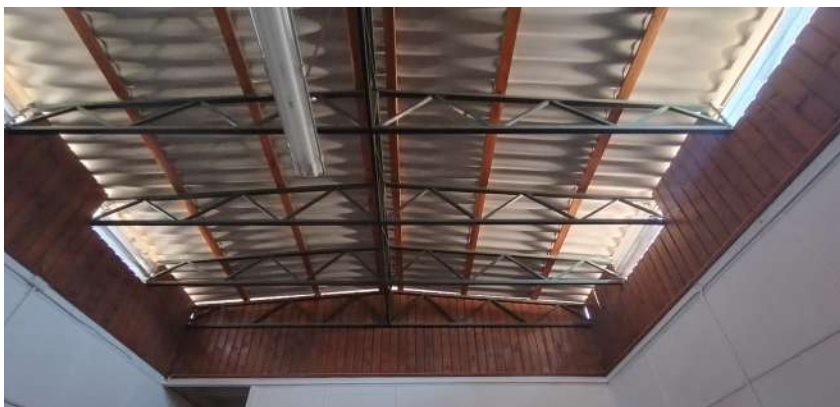
Img. n°43 Registro fotográfico de estructuras de cubiertas metálicas no originales, obtenido mediante levantamiento y documentación en terreno el 5 de septiembre de 2024, evidenciando la pérdida de lectura de techumbre original de explicación que precede. © Corsa Arquitectos.
